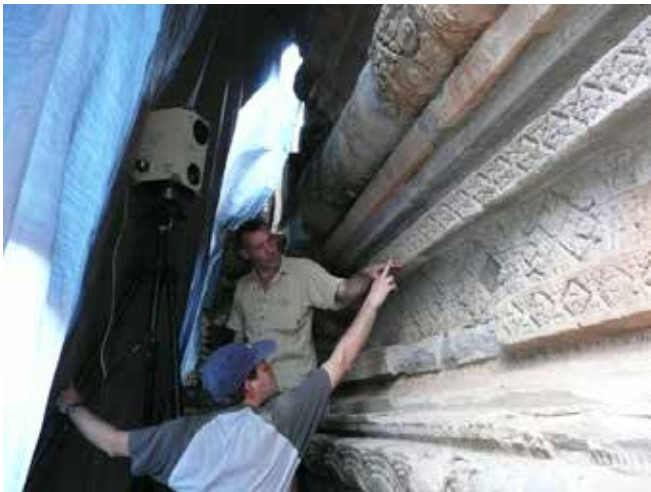
Cartographie et mesure de l'érosion des motifs sculptés des temples d'Angkor (Cambodge) à l'aide d'un laser scanner courte portée (programme Ta Kéo - Dir : M.-F. André)
